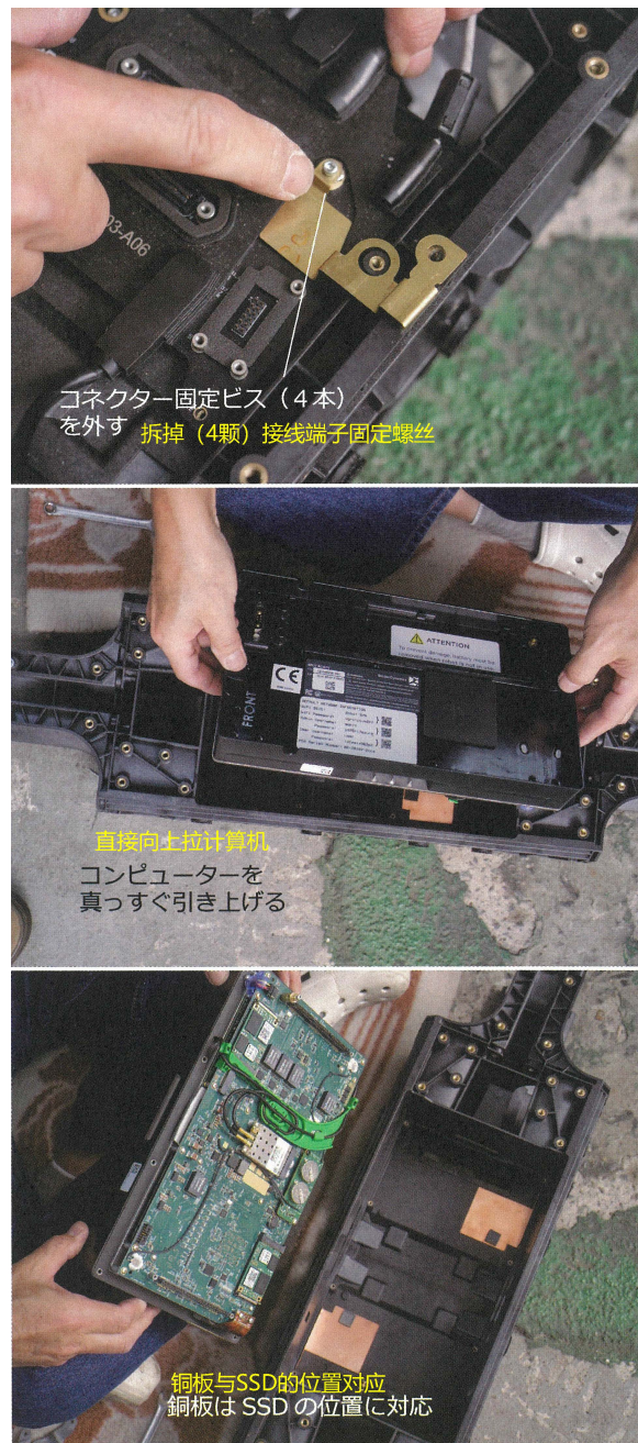
图 6.31: 主计算机的固定位置 拆掉它周围的8颗螺栓后, 通过拆下连接端板的连接器两侧的螺丝 (前后各2颗) 即可将其分开。(照片:加藤 康)
